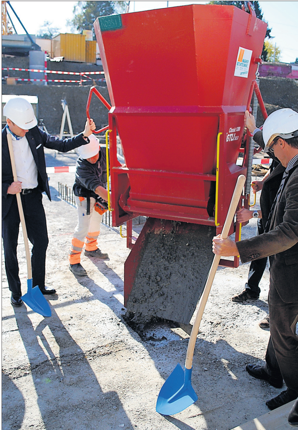
SPATENSTICH In den kommenden Monaten wächst das Schlieremer Zentrum in die Höhe. SKE
